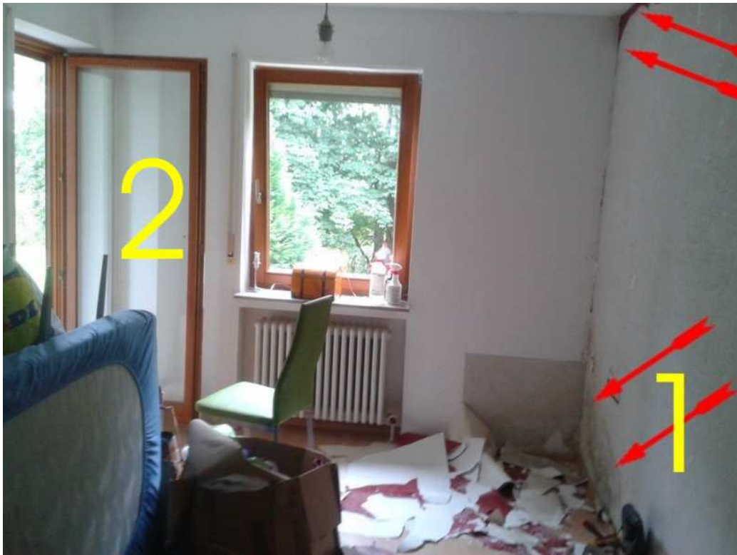
Bilder Mieter lüftet nicht 5
