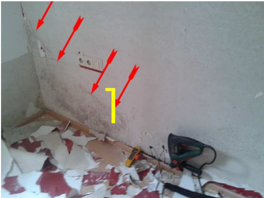
Bilder Mieter lüftet nicht 6
