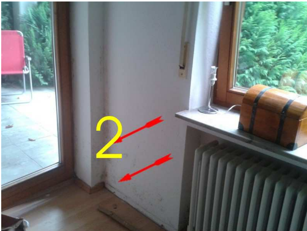
Bilder Mieter lüftet nicht 12
