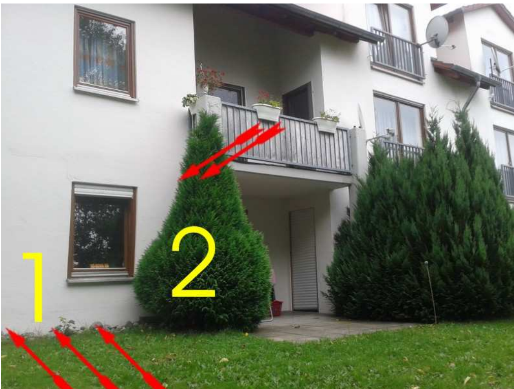
Bilder Mieter lüftet nicht 4
