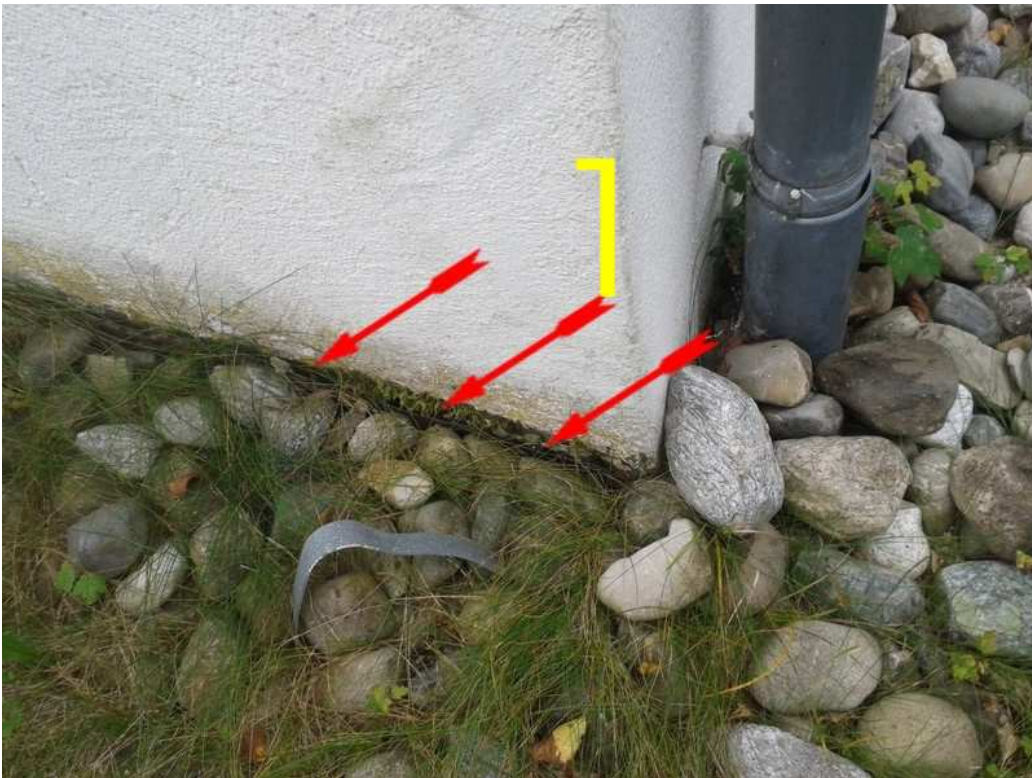
Bilder Mieter lüftet nicht 3
