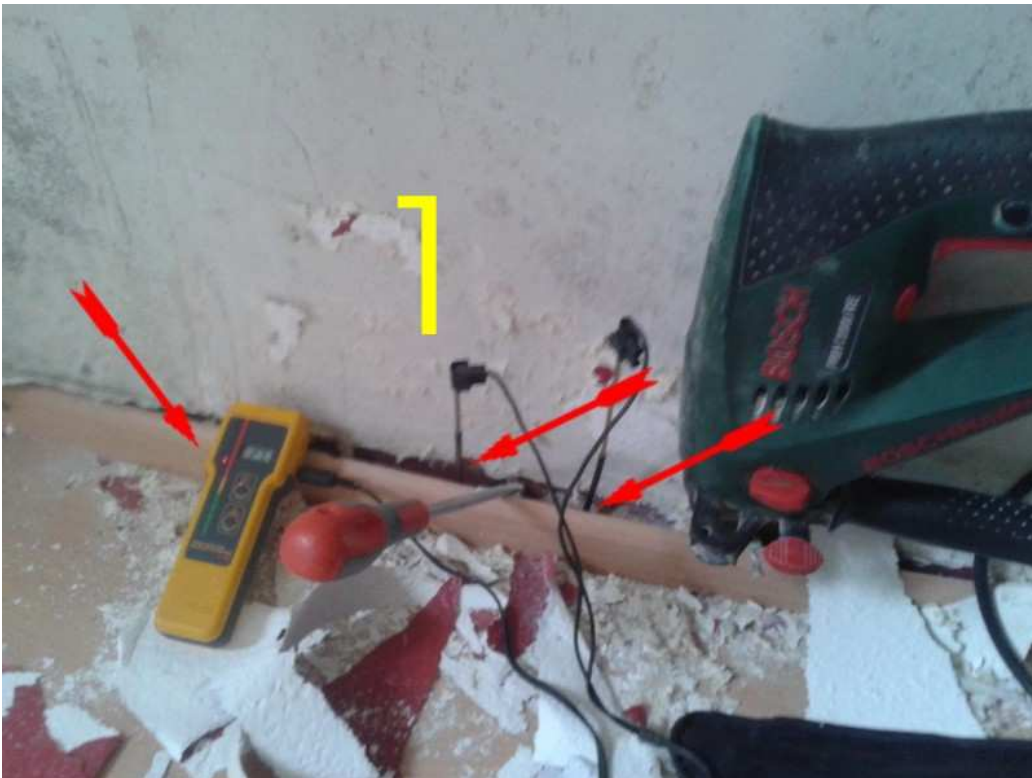
Bilder Mieter lüftet nicht 7
