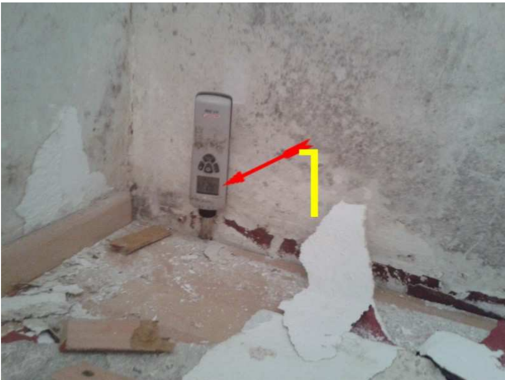
Bilder Mieter lüftet nicht 10
