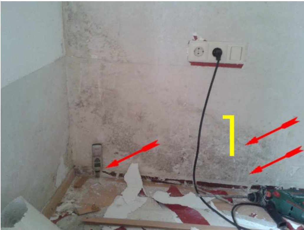
Bilder Mieter lüftet nicht 9
