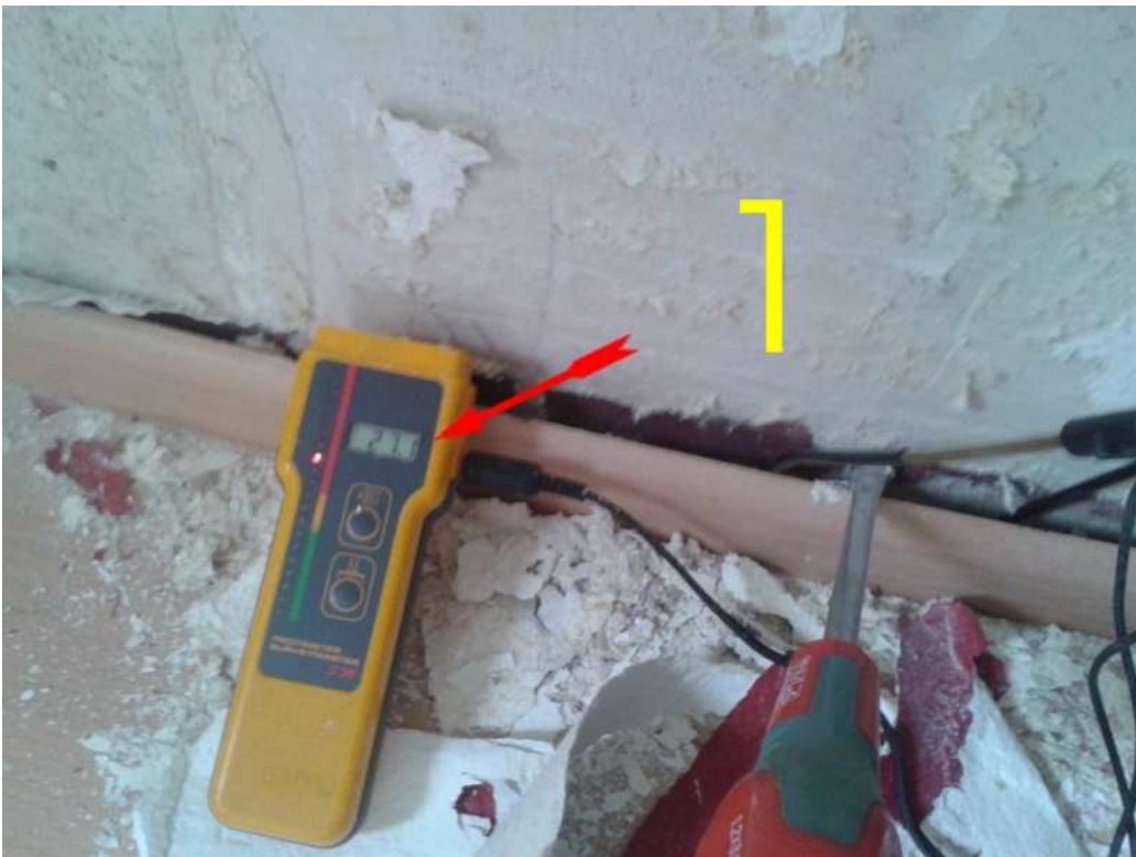
Bilder Mieter lüftet nicht 8
